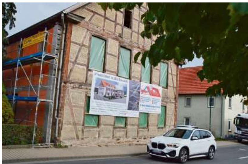
So kennt man das alte Fachwerkhaus bislang von der Hauptstraße her. Mittlerweile trägt es auch vorn ein Gerüst. Zum Nachbarn entstand eine Brandwand.
